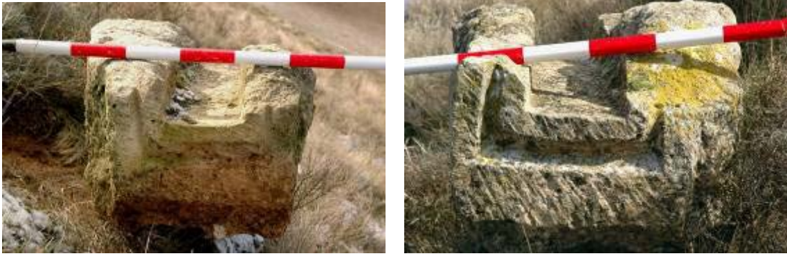
Piezas de canal tallado en piedra caliza del acueducto romano del Arca, en Sasamón. Se observan los entalles de la junta de impermeabilización en los que falta el mortero ( opus signinum ).
